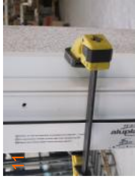
Kontroller ensartet spænd hele vejen rundt på både karm og alu-tilsætning.
